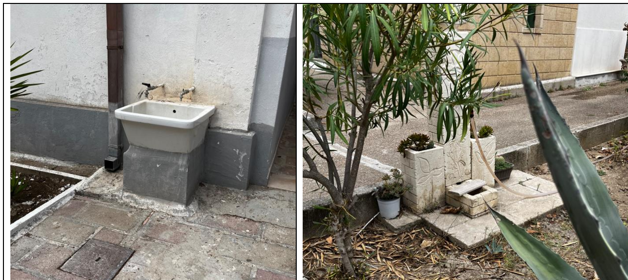
Figura 9-10- Tipologia di rubinetti e fontanelle attualmente presenti nell'area cimiteriale
