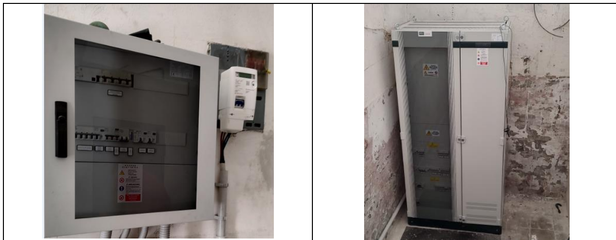
Figura 6 -7 – Quadro elettrico e sottoquadro presenti nell’area cimiteriale
